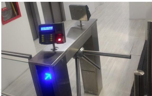
IN-2 sobre Pedestal Metálico
